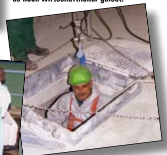
2004: Achim Seifert wird in ein Zementsilo hinab gelassen. Die Innenreinigung des Silos eine Müller-Spezialaufgabe.
